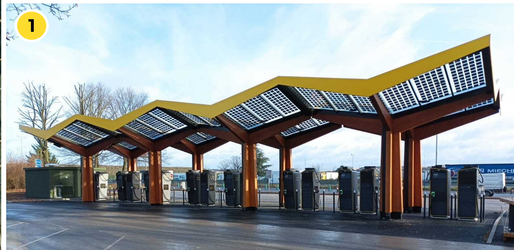
Aire de Vémars Ouest 16 x 300 kW chargers A1, France
